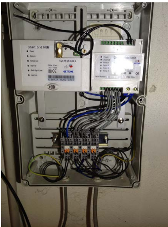
Montage und Anschluss SGHC/GCU mit Mobilfunkantenne, RS 485-Verbindung a & b von SGHC auf GCU
